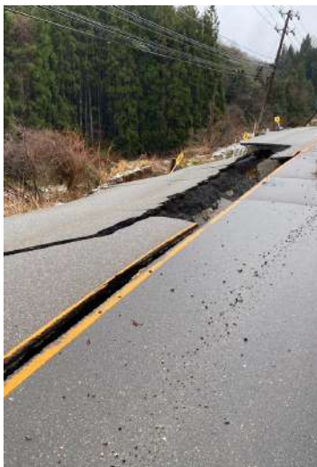
写真：通行が困難な道路状態
